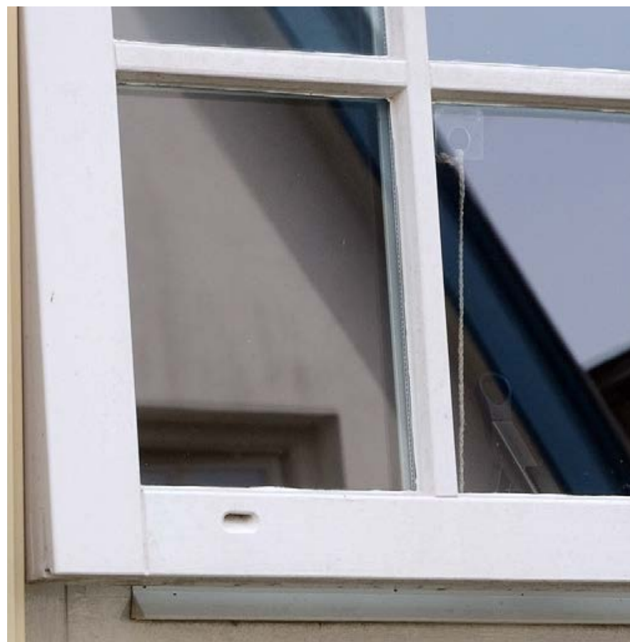
▲ Afbeelding XXXI Nieuw naar buiten kleppend bovenlicht ter plaatse van een voormalig schuifraamvenster, met een binnenbeglazing, ontwaterings-/beluchtigingsgat voor het isolatieglas links onder, plakroeden en v-groeven.
