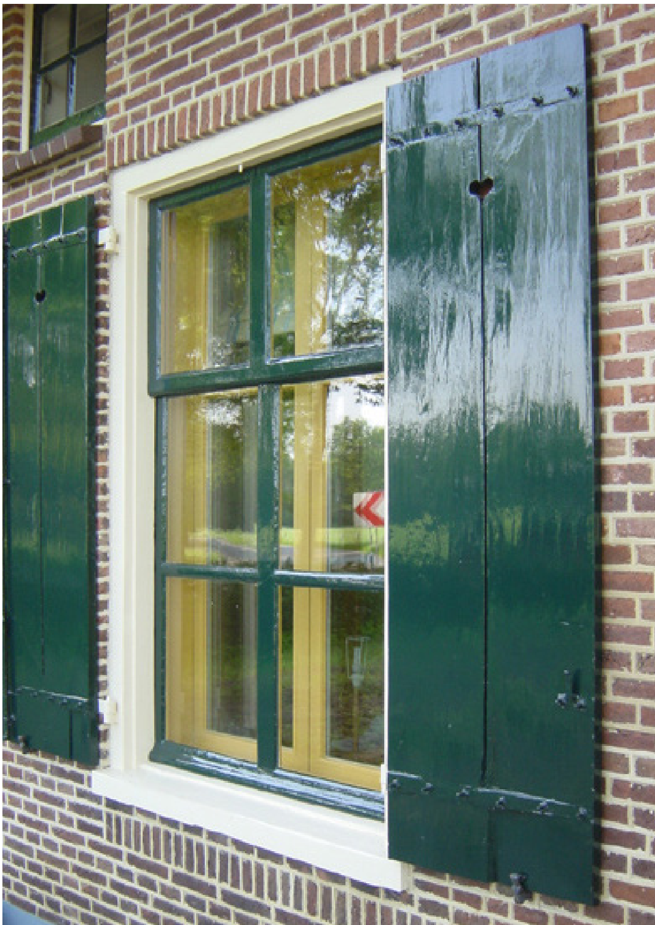
▲ Afbeelding XXXVII Dit houten achterzetraam is door de afmetingen van het raamhout en de kleur te prominent aanwezig in het aanzicht van het schuifraam.
